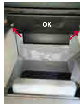
fig. 23 - Vista al deflettore dalla camera di combustione
